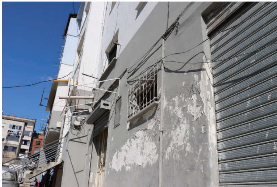
Një pallat i rikonstruktuar pranë stadiumit të Durrësit, ku ka rënë një pjesë e suvasë. Foto: Geri Emiri.
